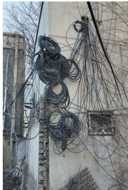
东花园里小区外墙网线乱如蛛网 龙中华 摄
