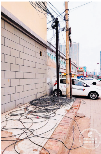
过去随意堆积的电缆
