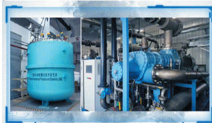
↑国产化液氮温区大型低温制冷系统(中科院理化所供图)
