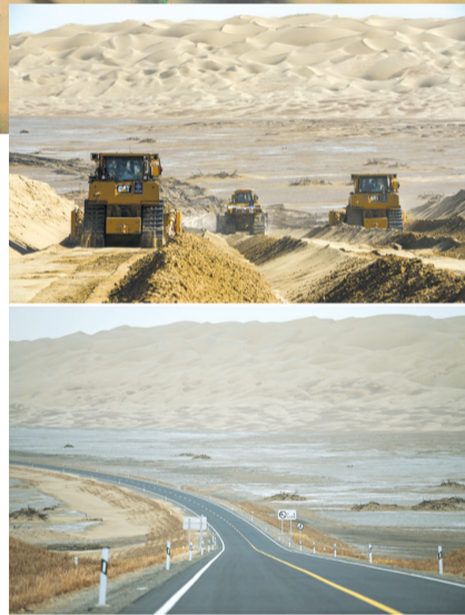
拼版照片：上图为2018年7月5日拍摄工人驾驶推土机在尉犁至且末沙漠公路施工现场进行路基施工；下图为2022年6月24日在尉犁至且末沙漠公路拍摄的同一路段。
