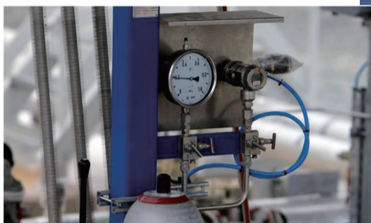
▲ 这是6月28日在罗马尼亚康斯坦察县瓦杜村拍摄的天然气处理站的设备。(资料图)
