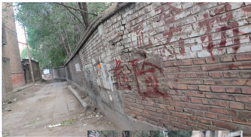
↑ 墙体倾斜严重 → 污水井外溢多时 龙中华 摄
