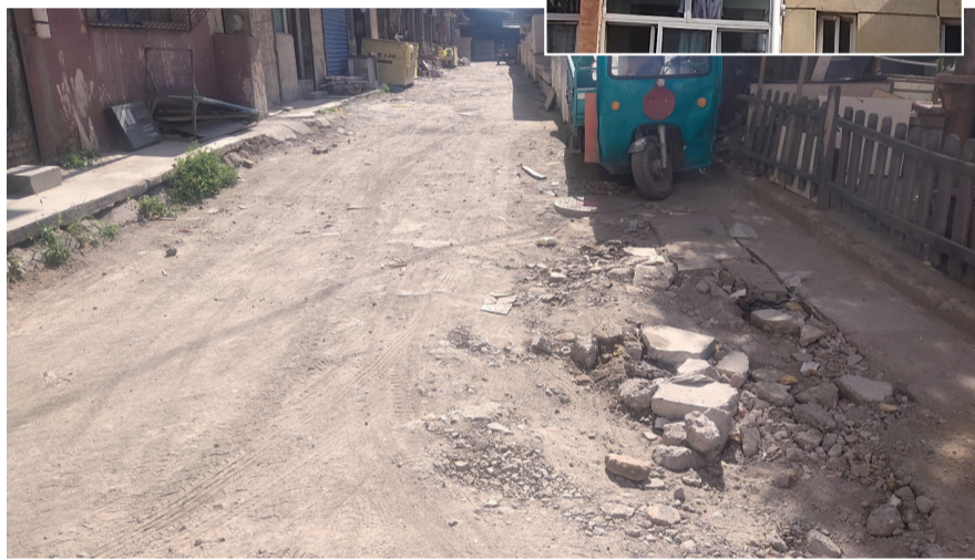
▼ 小区路面坑洼不平 龙中华 摄
