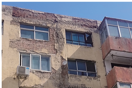
▲ 楼房墙皮脱落严重
