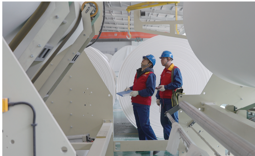
电力人员在山西云冈纸业有限公司检查用电安全隐患 张彩峰 摄
