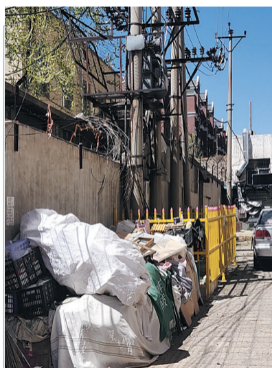
供电变压器设施附近堆积的各种杂物 龙中华 摄
