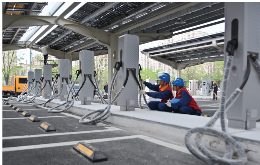
樊庄“光储超充”一体化智能充电站 张彩峰 摄
