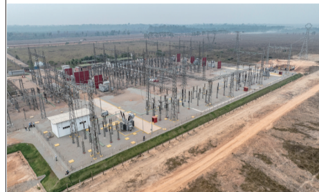
▲ 这是9月13日在巴西朗多尼亚州拍摄的EDP输变电项目阿布南变电站(无人机照片)。
