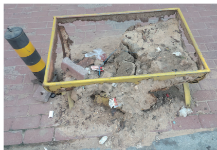
花池锈蚀塌陷 龙中华 摄
