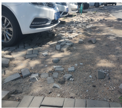
便道大量地砖砖块翘起散落 龙中华 摄
